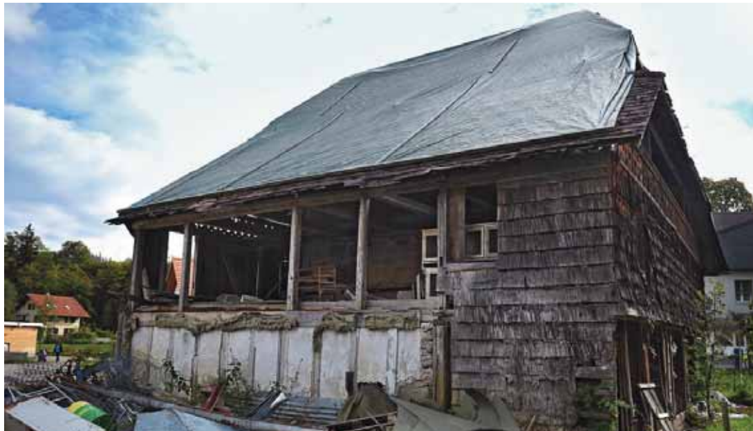
So sieht es heute aus: Der Speicher wird nicht mehr benötigt und ist aussen in einem schlechten Zustand.
